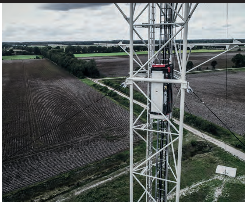
Stahl-Wettermast (Meppen), TOPlift, 80 m Turmhöhe
